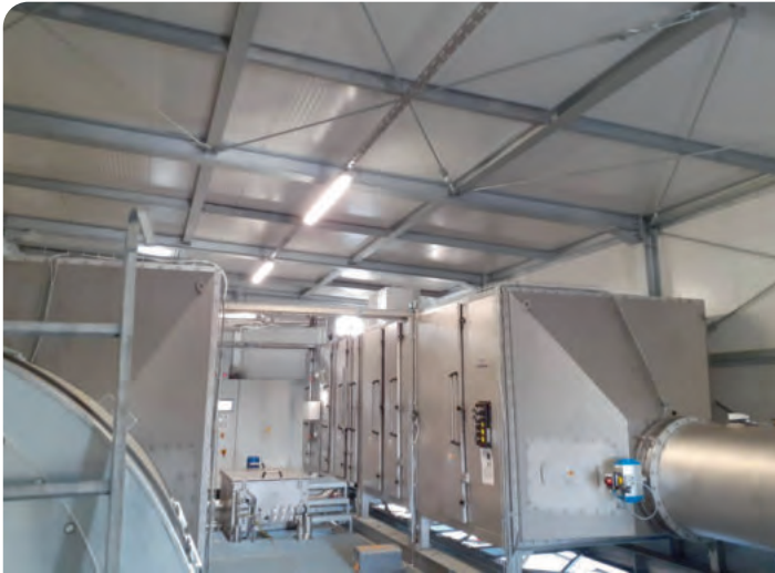
Zwei Abluftfiltersysteme für ein Gesamtabluftvolumen von 60 000 m 3 reinigen die geruchsbeladene Abluft und gewinnen Prozessabwärme zurück.
