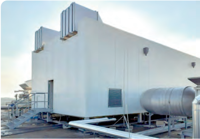
Im Wetterschutzgehäuse auf dem Hallendach ist die zentrale Filteranlage positioniert.
